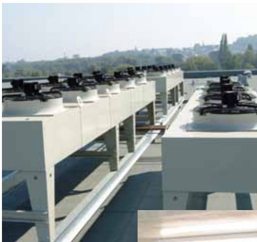
Klima- und Kälteanlagen
