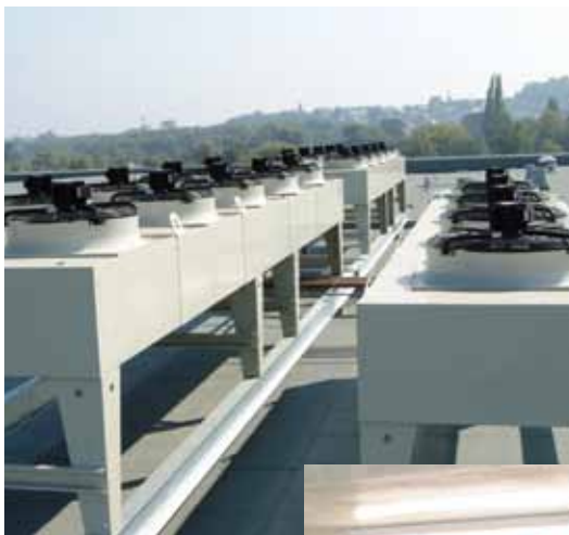
Klima- und Kälteanlagen
