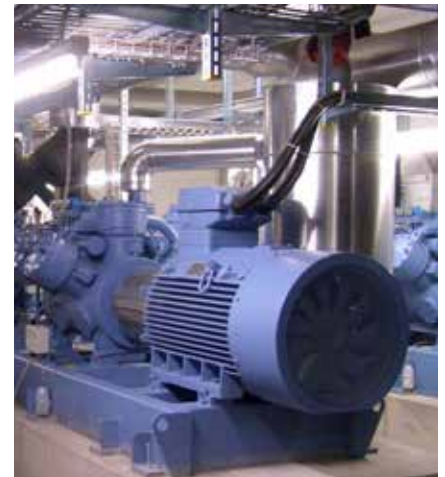
Picture courtesy Wettstein Kältetechnik
