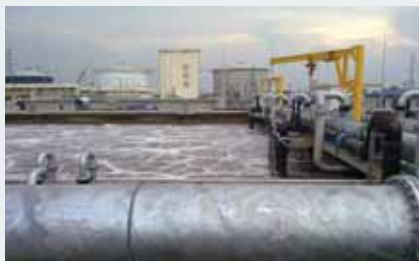
Kläranlage, Hanoi, Vietnam Die Kläranlage, Yen So Park, behandelt 50% des Abwasseraufkommens in Hanoi. Mehr als 90 Frequenzumrichter sind installiert, zwölf davon sind 450kW VLT® AQUA Drives zur Regelung der verschiedenen Gebläse
