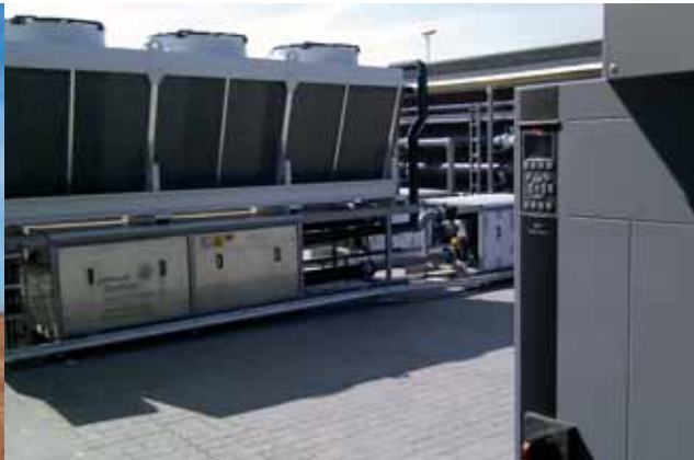
医院安装的两个用于 HVAC 的 VLT® 高级有源滤波器，可确保为重要设备稳定供电。
