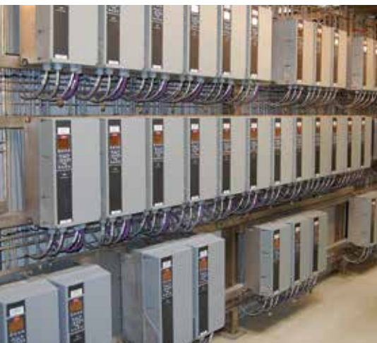
Una tipica installazione con convertitori di frequenza multipli, tutti con una stessa alimentazione, spesso questo tipo di installazione richiede un'ulteriore mitigazione delle armoniche per evitare la distorsione della tensione.
