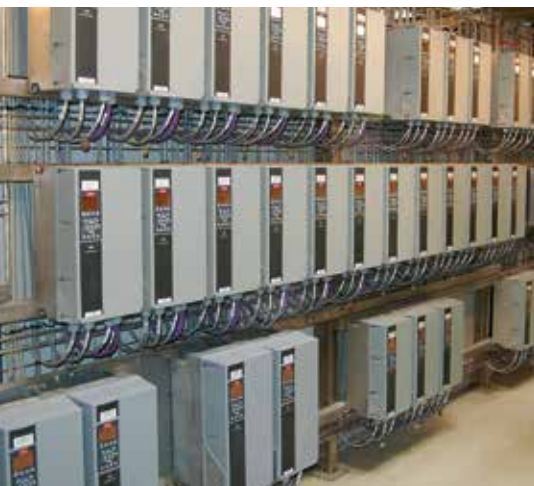
Typický pohon s několika měniči kmitočtu, které jsou všechny napájeny ze stejné rozvodné sítě, vyžaduje často dodatečné snížení úrovně harmonických kmitočtů, aby se zabránilo zkreslení průběhu napájecího napětí.
