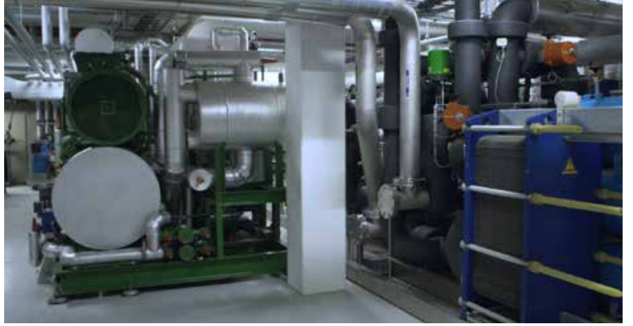
Isı eşanjöründe soğutulan su odaları istenen sıcaklığa soğutmak üzere binada dolaşıma sokulur. Aktif soğutma gerekmez.
