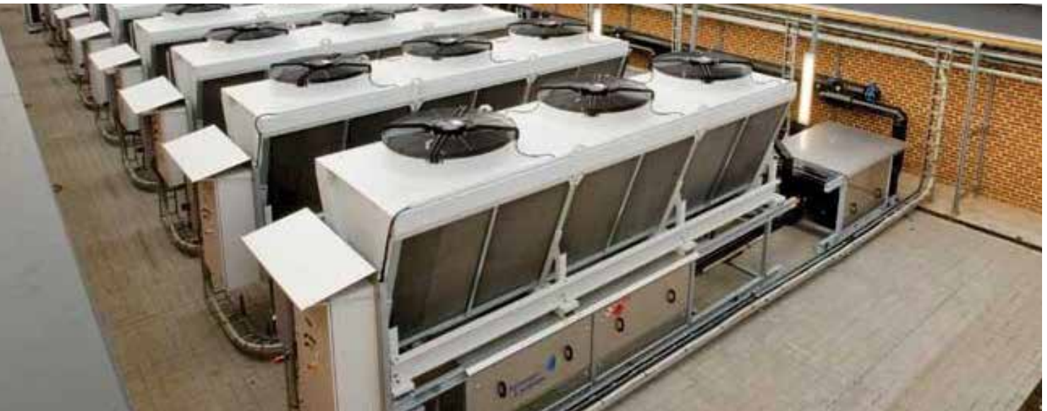
Chillers i roof-top installation på Skejby Sygehus. På hver chiller er installeret en VLT® HVAC Drive FC 102, 90 kW, IP55 kapsling og en VLT® HVAC Drive FC 102 5,5kW.
