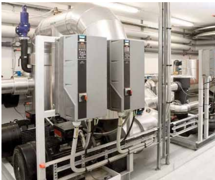
VLT® HVAC Drive FC 102, 37kW, IP55 kapsling installeret på pumpecentralen.
