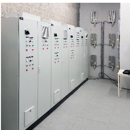
L'un des deux locaux techniques avec des résistances de freinage sur le mur du fond.
