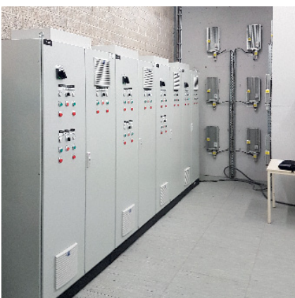
Jedna od dve tehničke prostorije sa kočionim otpornicima na daljem zidu.
