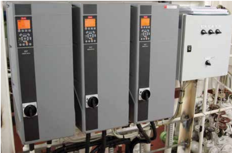
Frekvensomformerløsningen hos Dampskibsselskabet NORDEN A/S består af 3 VLT® AQUA Drive FC 202, 45 kW frekvensomformere med kaskadekontrol, en elektrisk switchboks til kontrol og to temperaturtransmittere.
