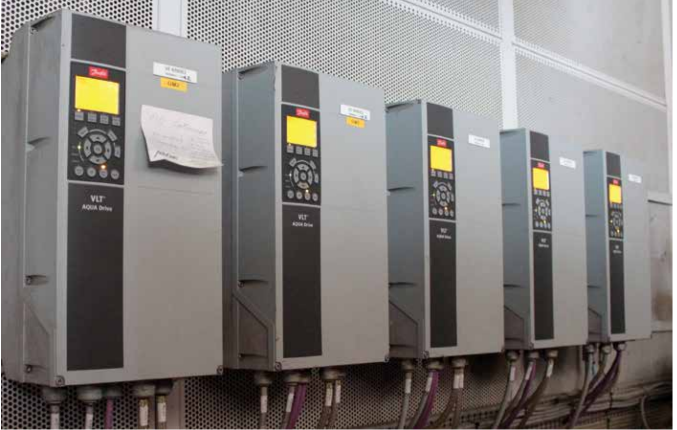
Biyogaz ile elektrik üretimi: VLT® AQUA Sürücü soğutma fanlarını ve takviye tesisini kontrol ediyor.
