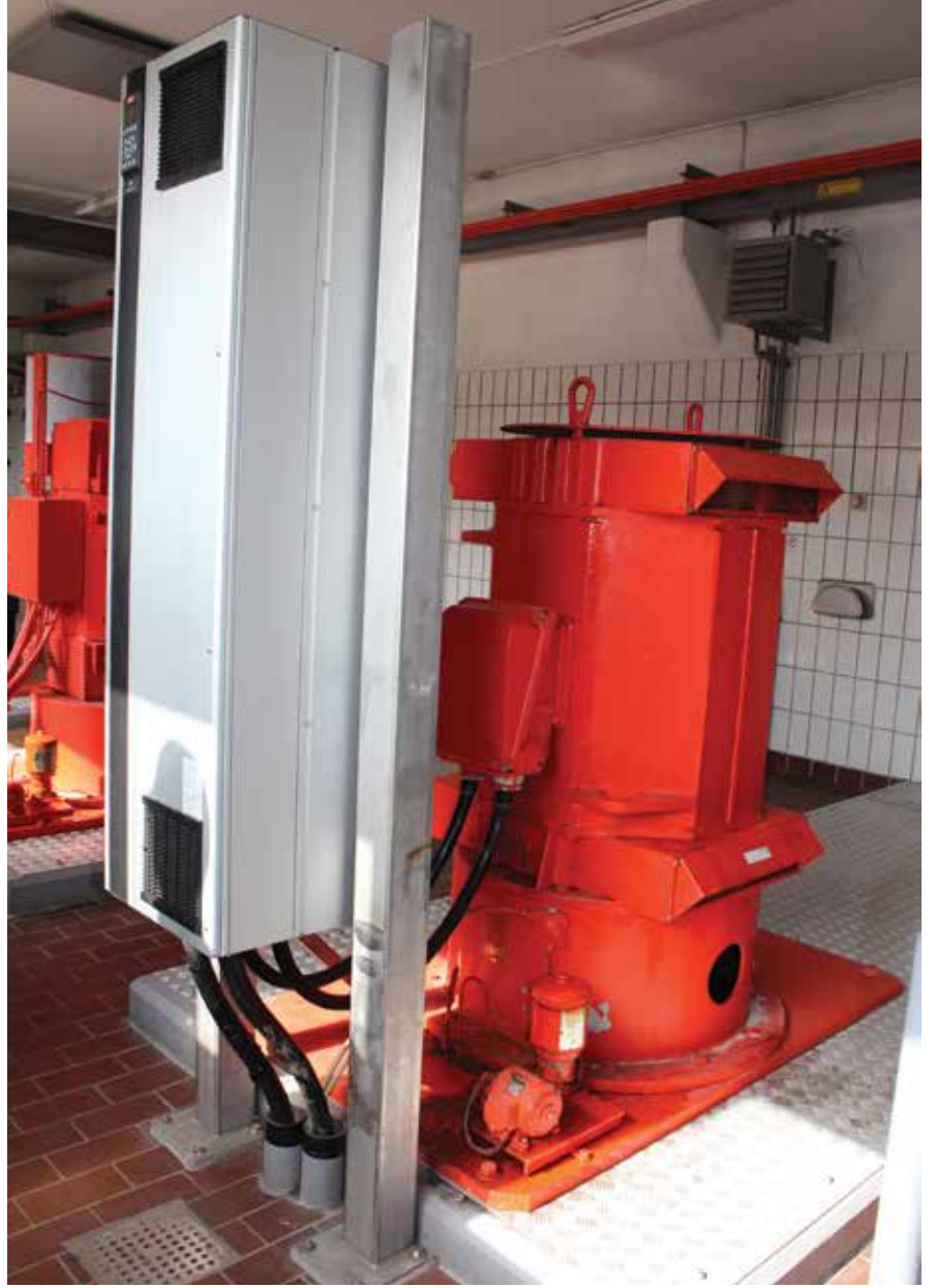
Tahliye pompalama istasyonu: IP 54 koruma sınıfına sahip nominal 160 kW bir VLT® 1,25 ton ağırlığındaki bu pompayı kontrol ediyor
