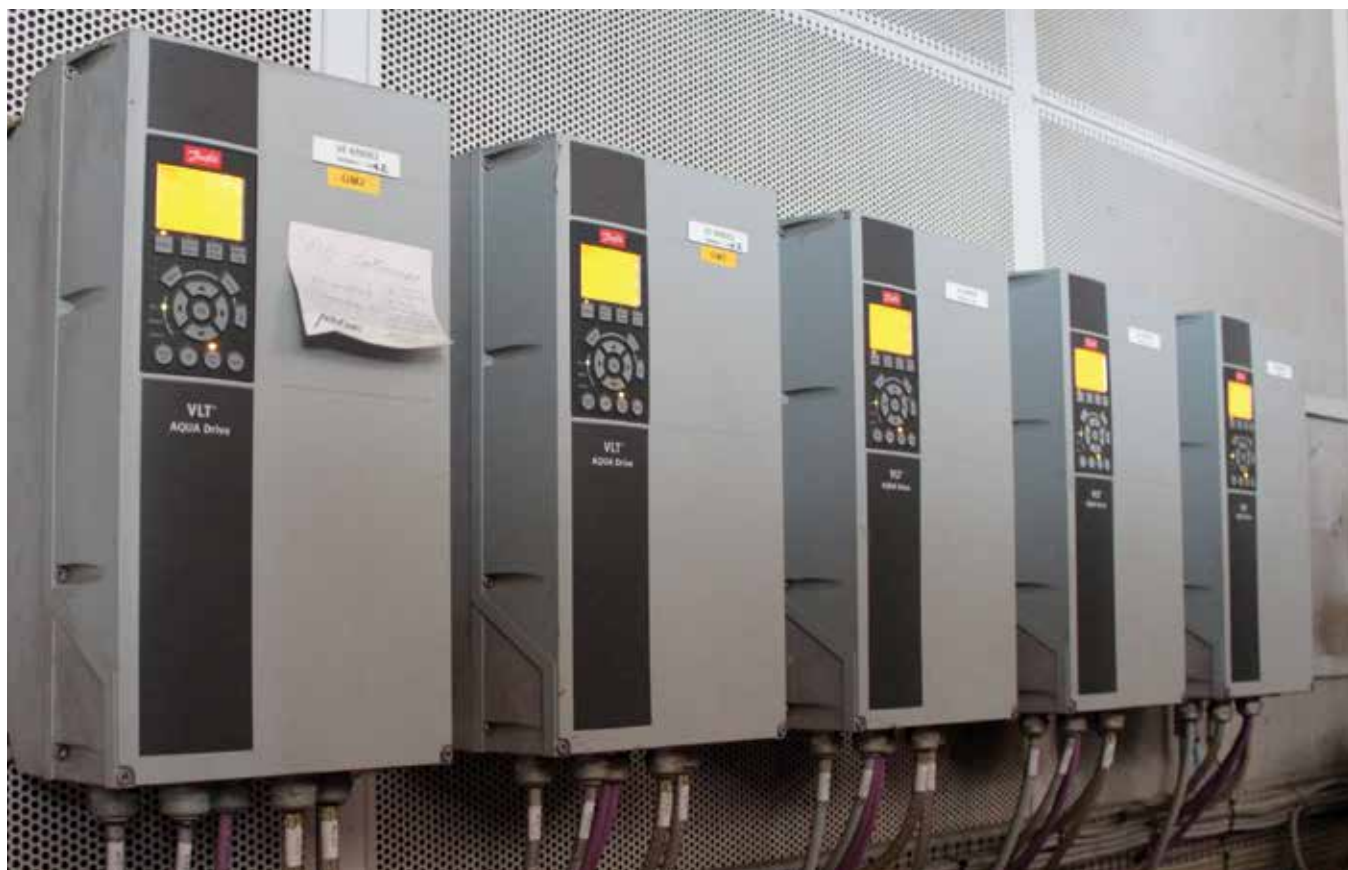
Wytwarzanie energii z biogazu: Przetwornice VLT® AQUA Drive sterują wentylatorami chłodzącymi i napędzają produkcję.
