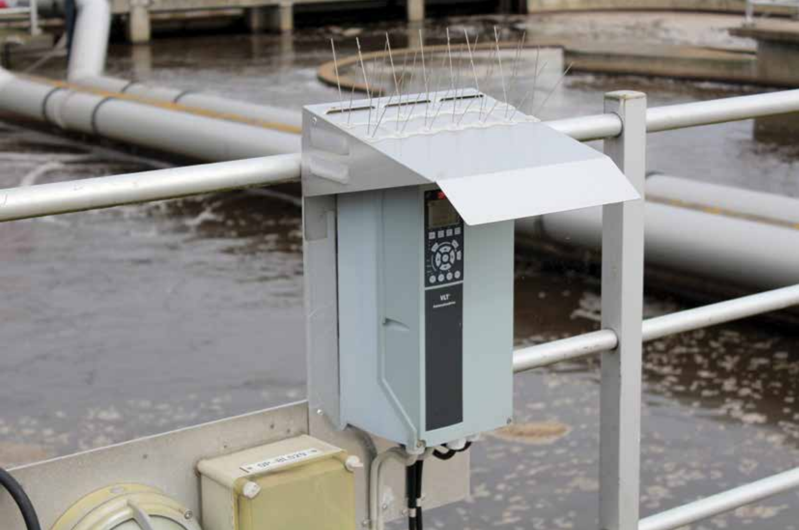
Aktywna nityfikacja i denityfikacja osadów: 16 przetwornic VLT® o mocy 4 kW z protokołem PROFIBUS, filtrem RFI, klasą obudowy IP 66 oraz osłoną klimatyczną kontroluje mieszalniki napowietrzające.
