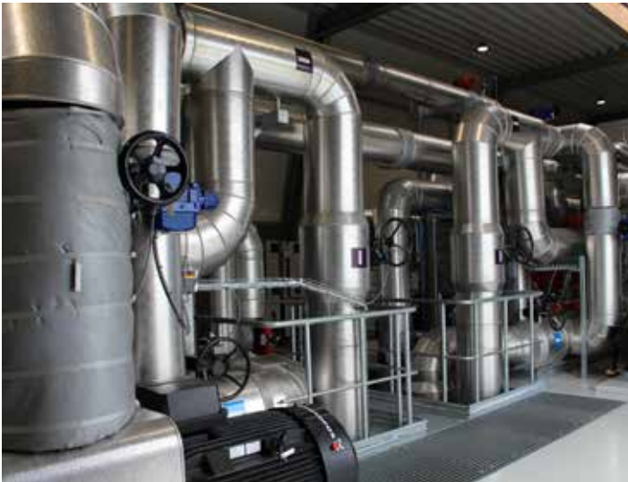
VLT® AQUA Drive styrer alle otte pumper på Silkeborg solvarmeanlæg.
