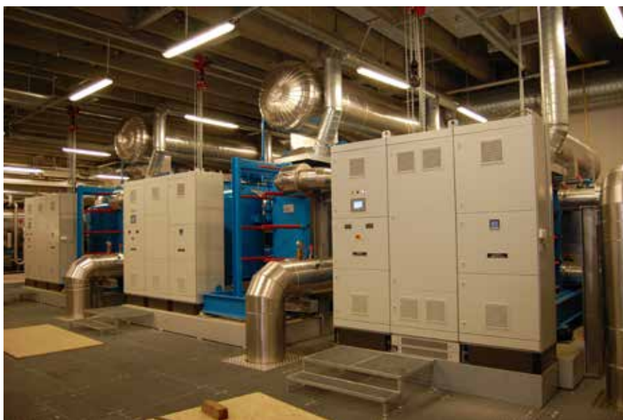
Het koelsysteem bestaat uit twee 3,5 MW schroefcompressoren en één 1,3 MW zuigercompressor.
