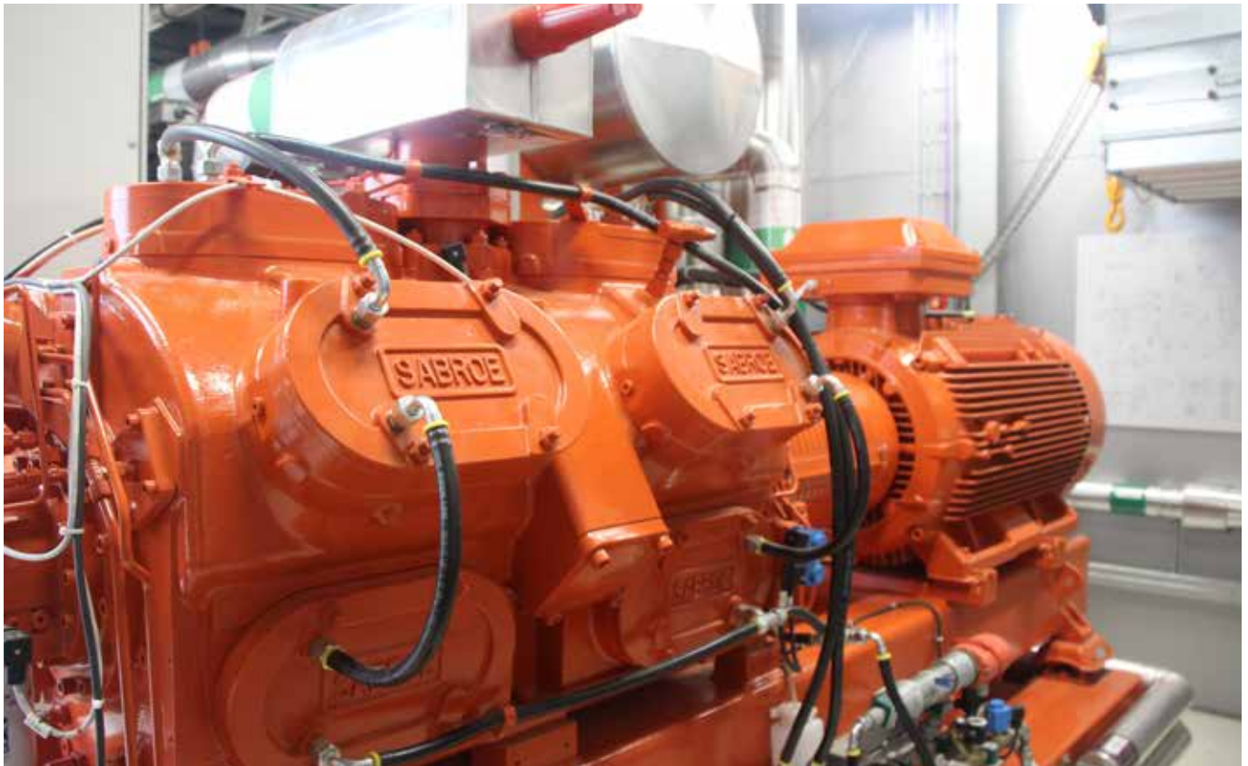
Värmepumpen styrs med frekvensomriktare och levererar varmvatten med en temperatur mellan 70–80°C till systemet, och sedan återförs vattnet till anläggningen med en temperatur på omkring 40 °C. Anläggningen levererades och installerades av Johnson Controls Aps i samarbete med konsulter från COWI A/S.
