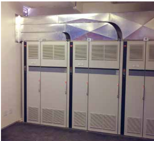
Przetwornice częstotliwości VLT® AutomationDrive z funkcją chłodzenia kanałem tylnym kontrolują silniki w systemie odprowadzania wody w kopalni. Zamontowane w podstacji MCC.
