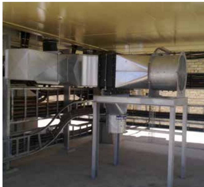
Filtr typu spin niewymagający konserwacji usuwa pył z powietrza zanim dostanie się ono do kanału radiatora przetwornicy częstotliwości.
