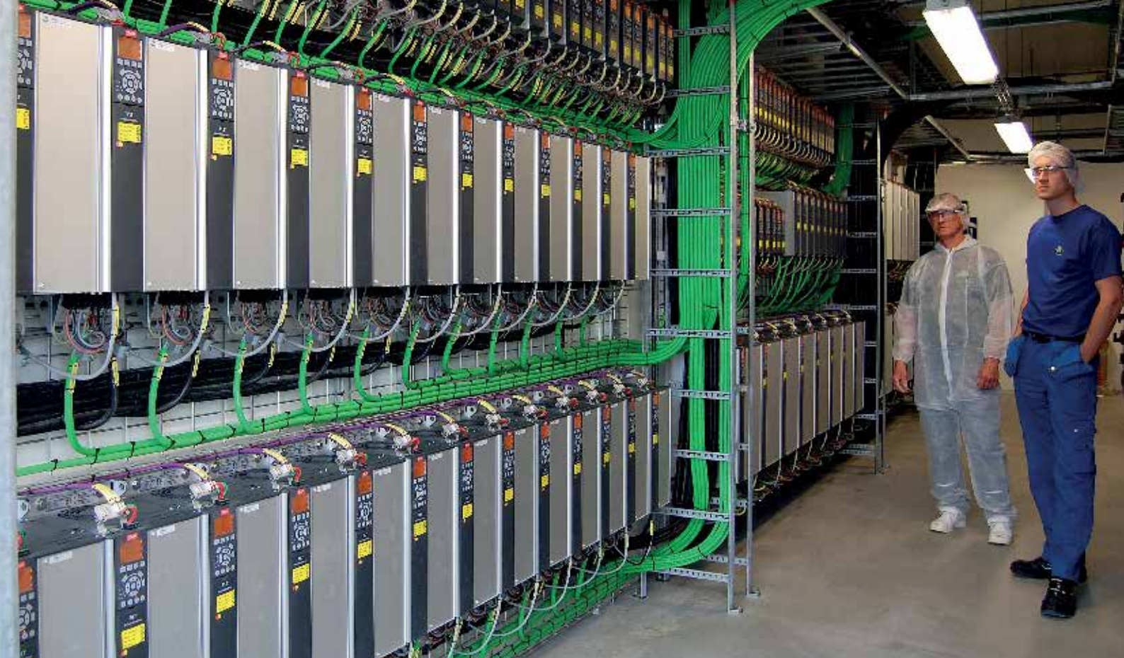
1400 przetwornic częstotliwości VLT® jest zamontowanych w wielu dobrze wentylowanych sterowniach bez potrzeby stosowania szaf sterujących. Od lewej Knud Rahbek oraz kierownik utrzymania ruchu Simon Arentoft
