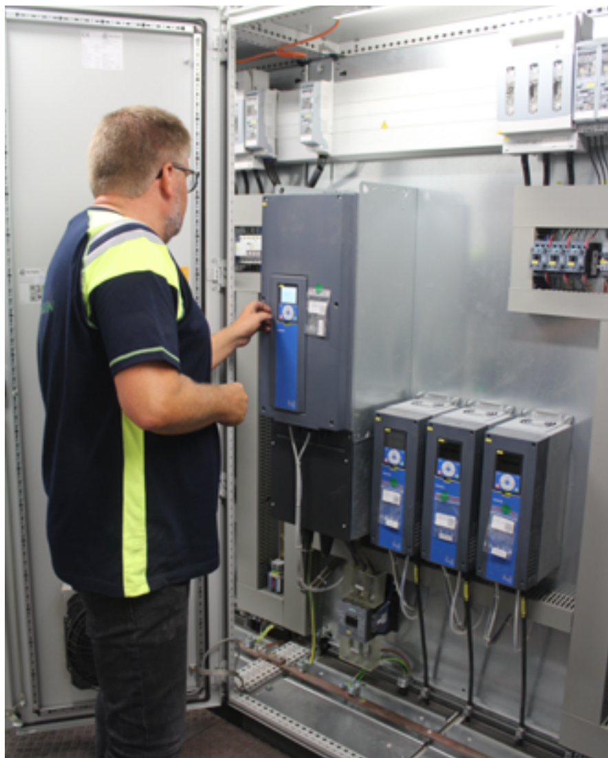
Danfoss Drives' VACON® 100 er leveret af Bilfinger direkte fra Tyskland i en container, klar til at blive taget i brug, da anlægget blev sat i drift i april 2018.
