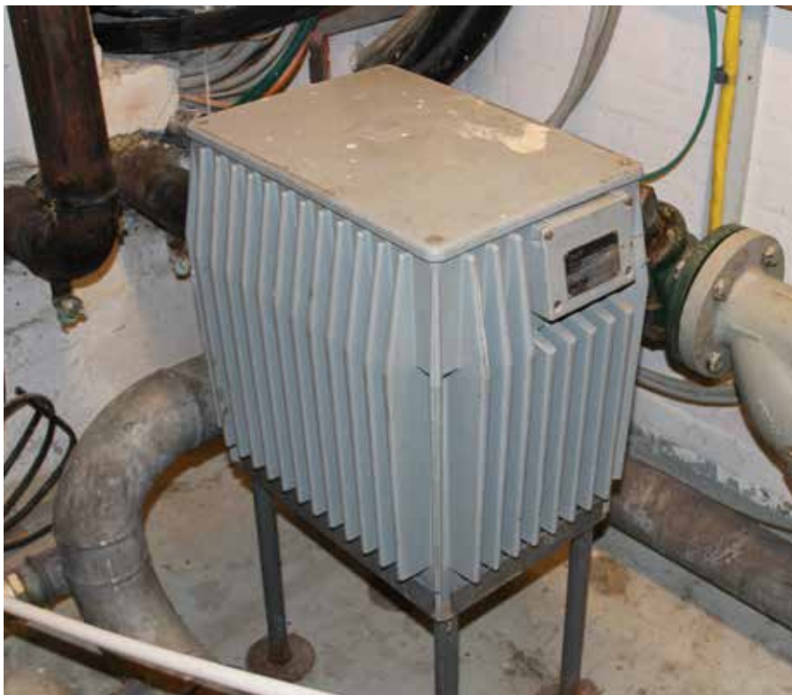
Denne VLT® 5 frekvensomformer har sikret pålidelig og energibesparende ventilation til Tønder Kommune i mere end 40 år.
