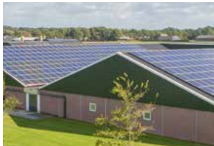
▲ Op het dak gemonteerde zonnepanelen
