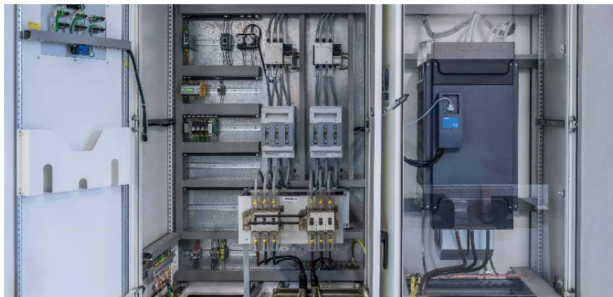
De configuratie van de schakelkasten na de vervanging met rechts de VACON® frequentieomvormer. De nieuwe omvormer neemt veel minder ruimte in dan zijn voorganger.
