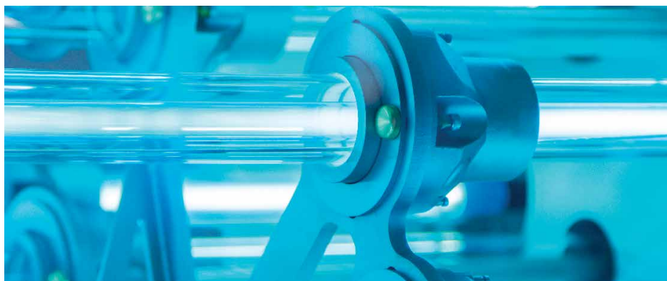
Detail van de plaatsing van de UV-lampen die het aangevoerde water zuiveren voordat het naar de duinen wordt gepompt.
