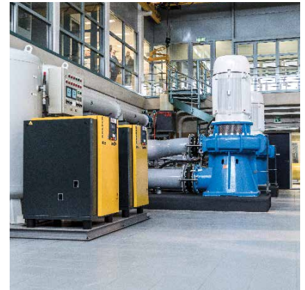
Om de grote hoeveelheid water door de hyperfiltratie te pompen, is veel vermogen en energie nodig. Frequentieomvormers zorgen er voor dat de pompen niet meer toeren maken dan noodzakelijk, waardoor veel energie wordt bespaard én het geluidsniveau wordt beperkt.
