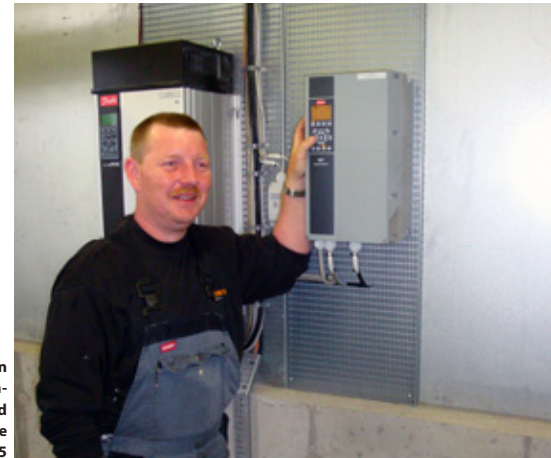
Varmemester John Nørgaard ved frekvensomformerinstallationen med VLT® AutomationDrive FC 302 4 kW IP 55
