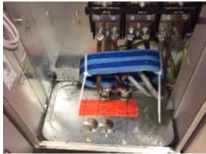
Fig. 6.21 Common-mode-kernen geïnstalleerd bij de klemmen van de regelaar
