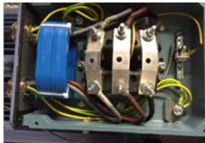
Fig. 6.22 Common-mode-kernen geïnstalleerd in de klemmenkast van de motor
