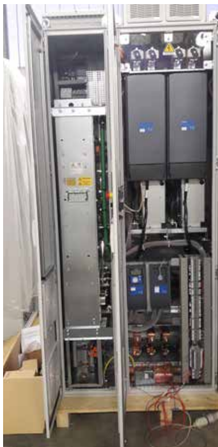
Quadro elettrico destinato al termovalorizzatore di Edimburgo in fase di collaudo finale nella fabbrica di Casagrande Elettrocostruzioni a Verona
