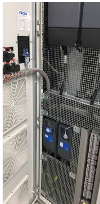
Particolare del quadro VFD che ospita un inverter della famiglia Danfoss Drives VACON® NXP
