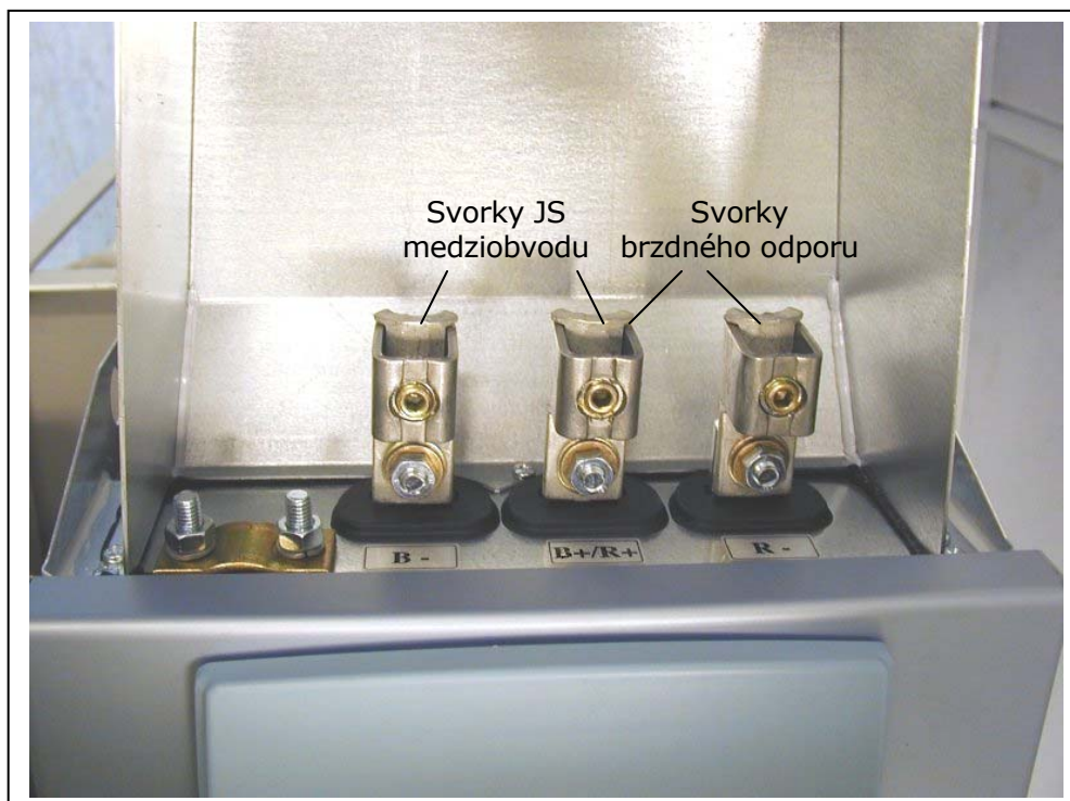
Obr. 6-17. Svorkovnica brzdného odporu na vrchu FR8;
