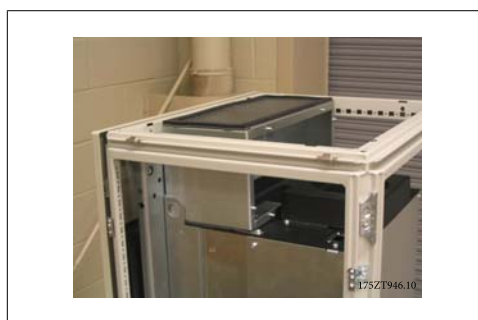
Bild 3.46: Övre kanal installerad
