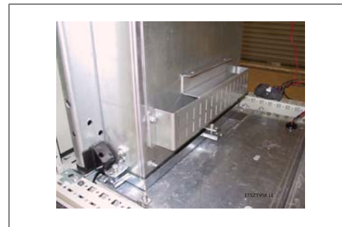
그림 3.59: 설치된 하단 덕트.
