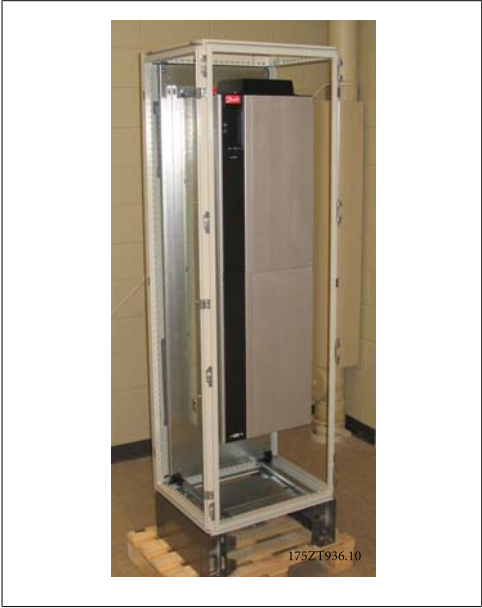
그림 3.36: 외함에 설치된 주파수 변환기
