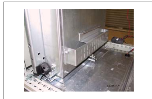
Ilustracja 3.59: Zamontowany dolny kanał kablowy.
