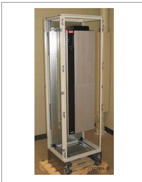
Kuva 3.36: Taajuusmuuttaja asennettuna kaappiin
