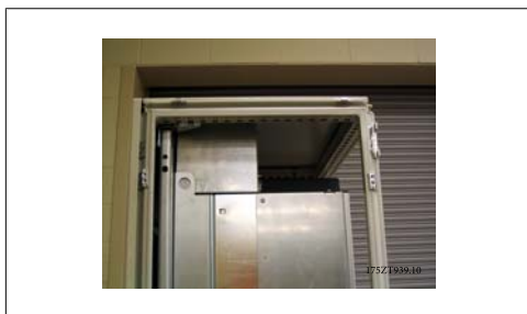
Ilustração 3.38: Tubulação superior e topo do gabinete metálico instalado
