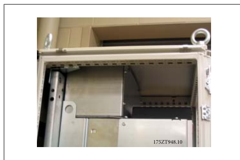
Ilustração 3.49: Parte de cima do gabinete metálico instalada
