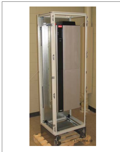
Ilustracja 3.36: Przetwornica częstotliwości zainstalowana w szafce
