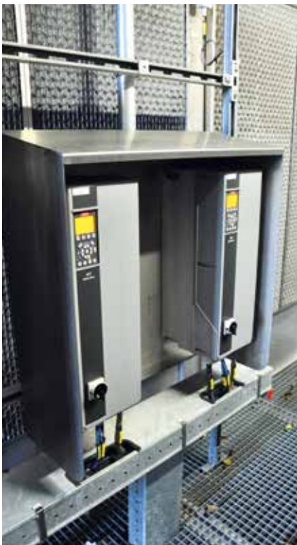
用于冷却塔调节的室外装置包括两台 VLT® HVAC Drive FC 102 变频器, 该变频器采用 IP55 机箱, 内置断路器。
