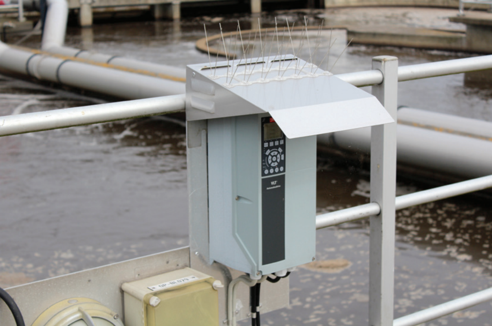
Biotanke med nitrifikation & denitrifikation: 16 stk. VLT® frekvensomformere på 4 kW med PROFIBUS, RFI filtre, IP 66 kapsling og beskyttelsesafdækning kontrollerer beluftningspumperne.
