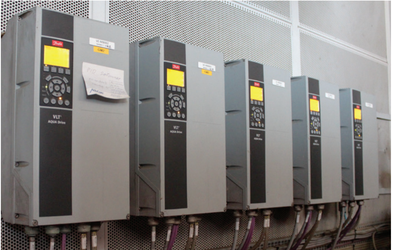
Biogas energiproduktion: VLT® AQUA frekvensomformere kontrollerer kølingsventilatorer og trykforøgningspumper.
