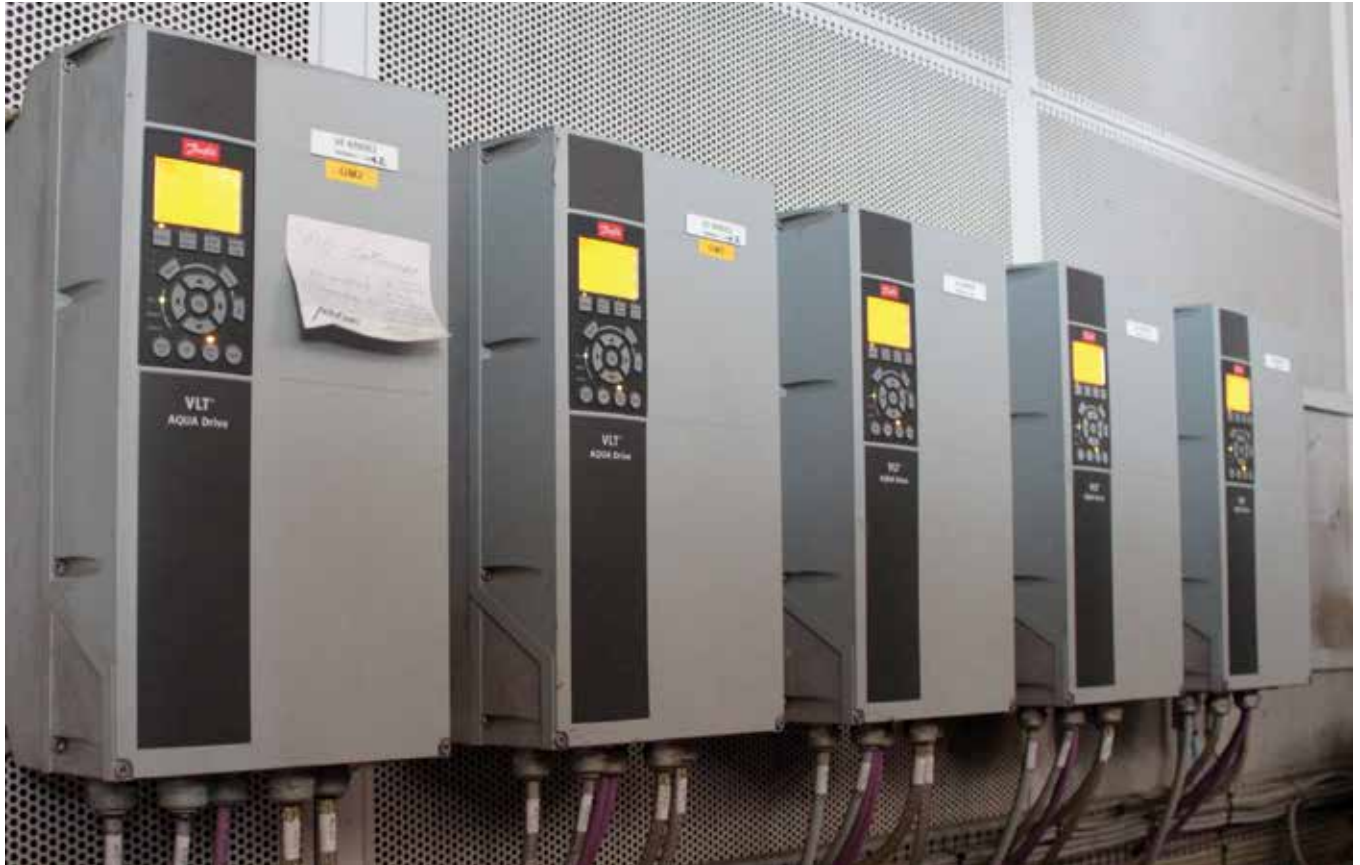
Production d'électricité grâce aux biogaz : les variateurs VLT® AQUA Drives commandent les ventilateurs de refroidissement et l'installation de surpression.
