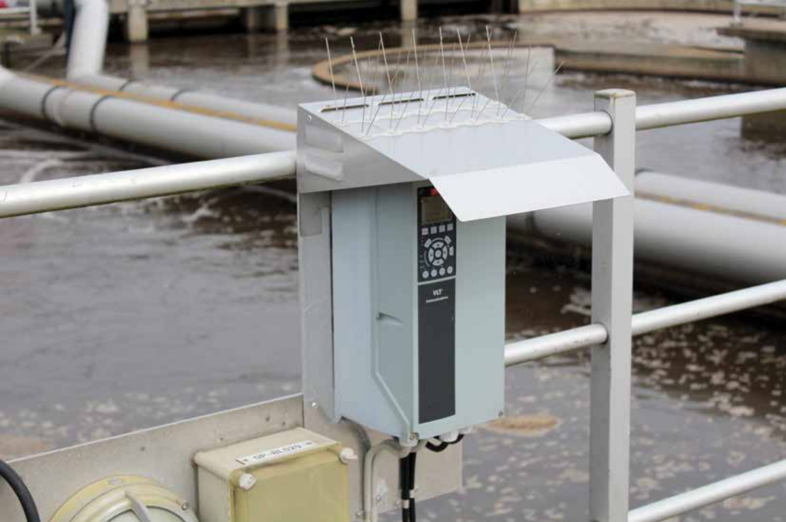
Nitrification & dénitrification avancées des boues : 16 variateurs VLT® de puissance nominale de 4 kW avec PROFIBUS, filtre RFI, niveau de protection IP 66 et casquette de protection, commandent les mélangeurs d'aération.
