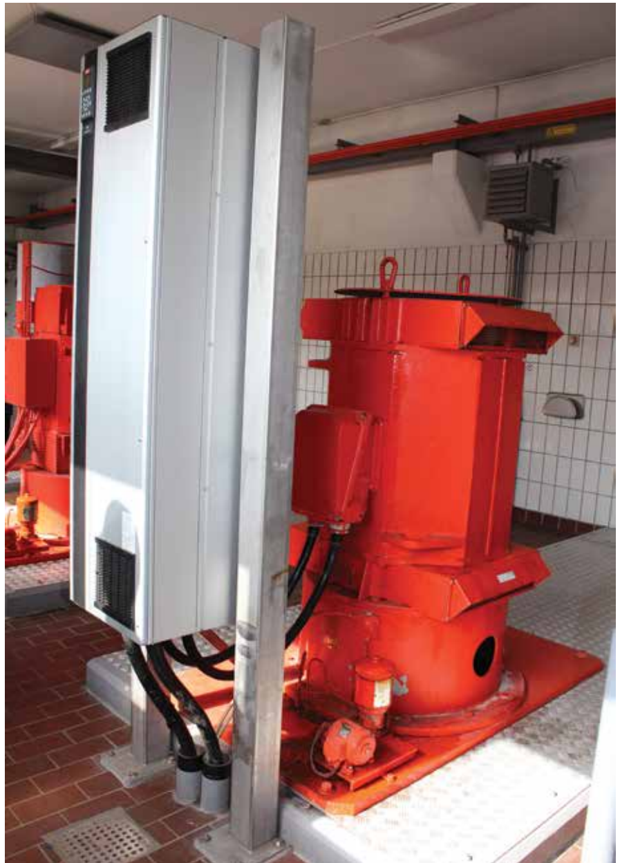
Poste de pompage d'évacuation : Un VLT® de puissance nominale de 160 kW avec boîtier IP54 commande cette pompe pesant 1,25 tonne
