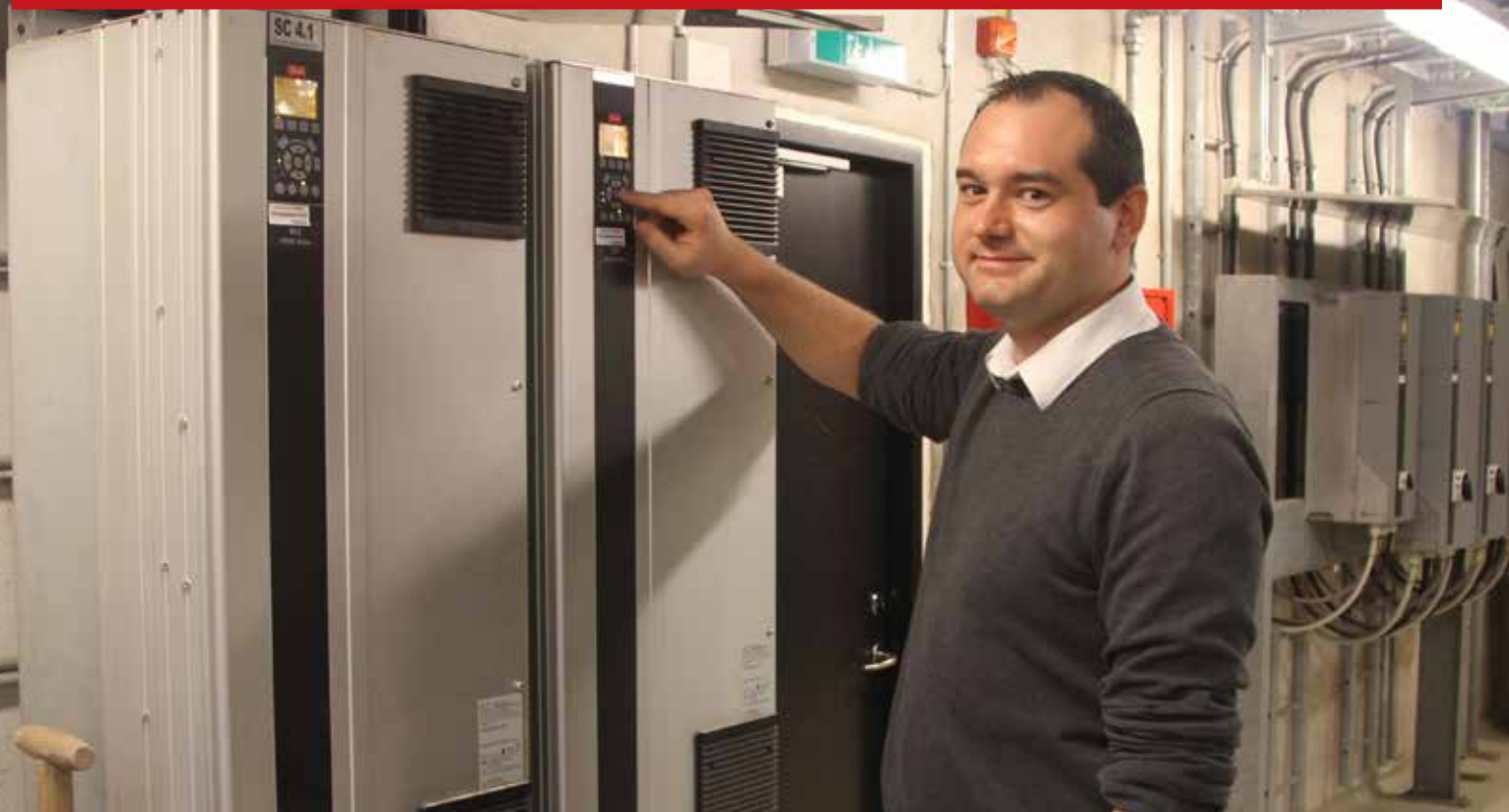
Admir Omeragic foran VLT® frekvensomformerne i Tietgensgades fjernkølingscentral
