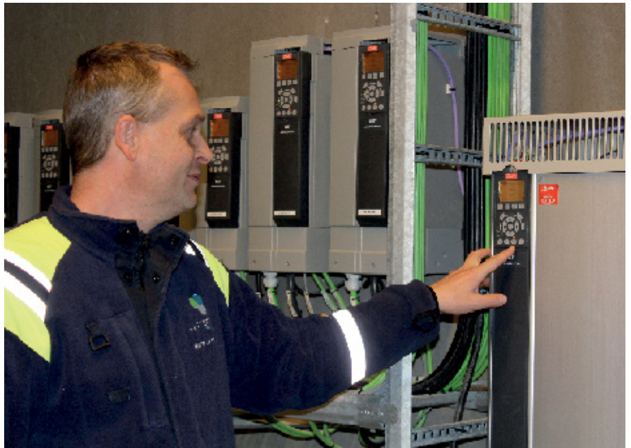
Elektriker Martin Lorentzen vid en 45 kW VLT® AutomationDrive FC 302 frekvensomriktare.
