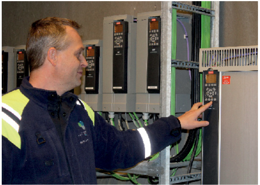
Martin Lorentzen, elektricien, naast een VLT® AutomationDrive FC 302 frequentieregelaar van 45 kW.
