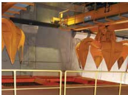
Kran til læsning af forskellige brændsler
