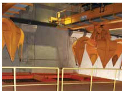
Grue de chargement pour différents types de combustible.
