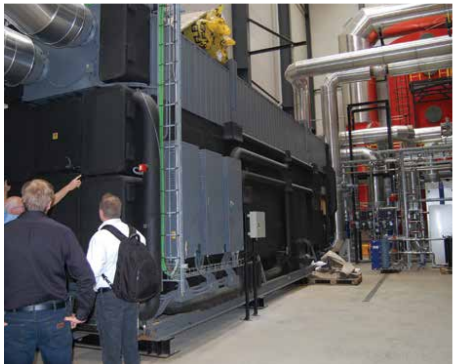
Absorbeur au premier plan. Épurateurs en arrière-plan.
