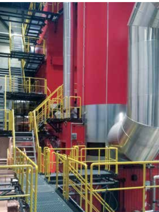
Chaudière verticale à biocarburants et épurateur des gaz de combustion par grenailage.
