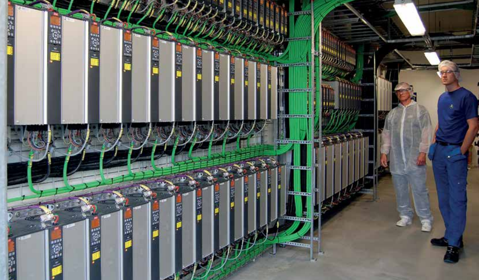
1400 przetwornic częstotliwości VLT® jest zamontowanych w wielu dobrze wentylowanych sterowniach bez potrzeby stosowania szaf sterujących. Od lewej Knud Rahbek oraz kierownik utrzymania ruchu Simon Arentoft
