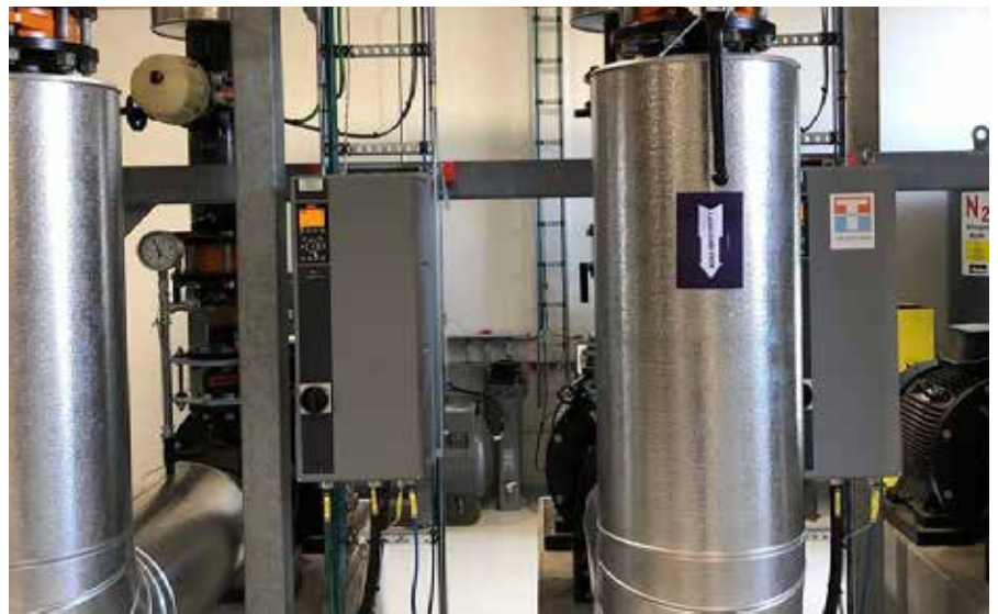
Hele anlægget strømforsynes af 27 Danfoss VLT®-frekvensomformere fra 0,75 til 400 kW.
