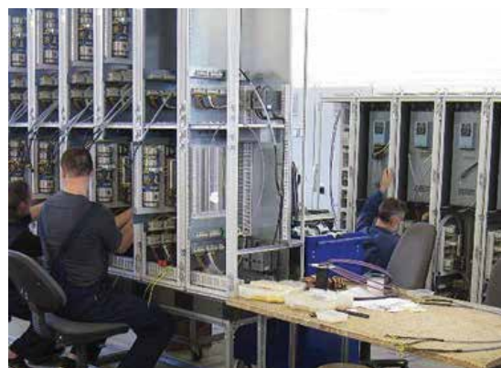
安装在开关柜中的VACON®有源前端/共直流母线模块。Vacon（伟肯）的有源前端技术符合最严格的谐波失真要求，经过挪威船级机构挪威船级社 (Det Norske Veritas) 认证。如果需要，它还可将绞车制动产生的能量回馈到船舶的电网中。
