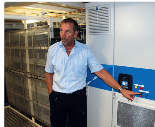
Søren Adersen erklärt das Leistungsumwandlungssystem, bei dem ein VACON® NXE Air Cooled-Microgrid-Umrichter zum Einsatz kommt. Die Batteriebank befindet sich auf der linken Seite.
