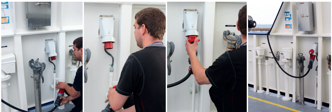
Die Besatzung schließt die Batteriebank an die Landstromversorgung an, um den Ladevorgang zu starten.
