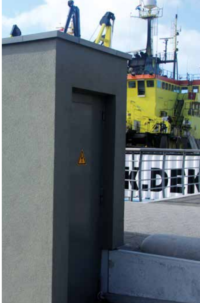
Het walstroomvoorzieningssysteem bevindt zich onder de grond. Hier is alleen de ingang zichtbaar.
