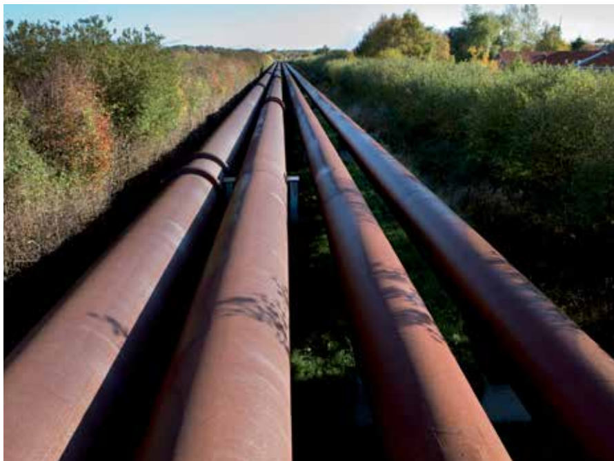
Transmissionsrør, fjernvarmenettet i Aarhus området. kilde: www.affaldvarme.dk
