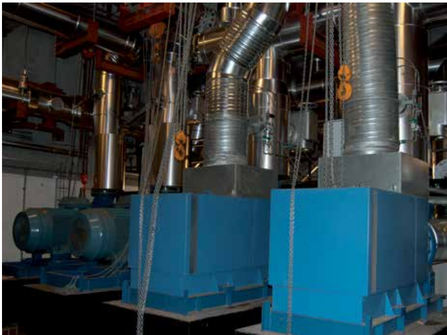
De to store 500 kW hovedpumper er styret af to nye Danfoss VLT® AQUA Drive FC 202 frekvensomformere.
