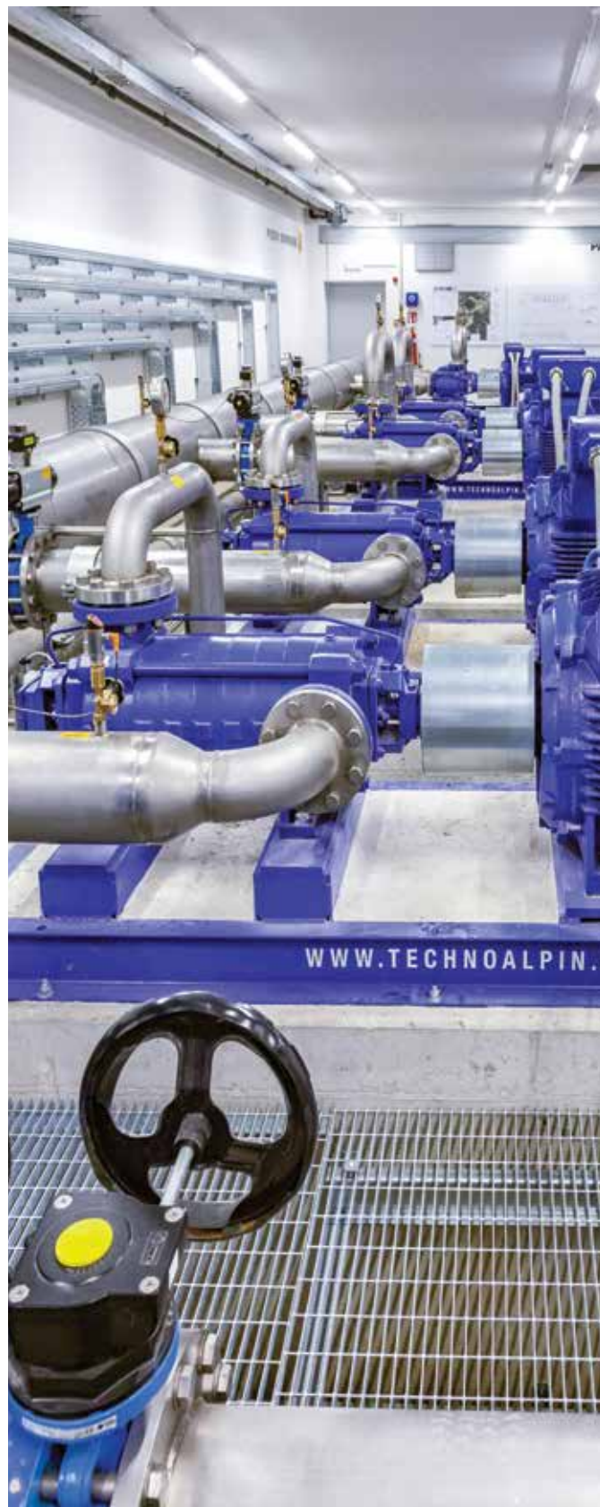
Bild av huvudpumpstationen, nedströms från anläggningen.
