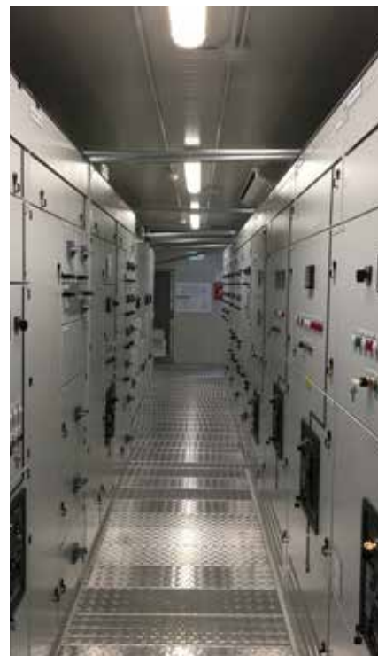
Interno di un container realizzato da Casagrande Elettrocostruzioni destinato all'impianto di termova-lorizzazione di Edinburgo
