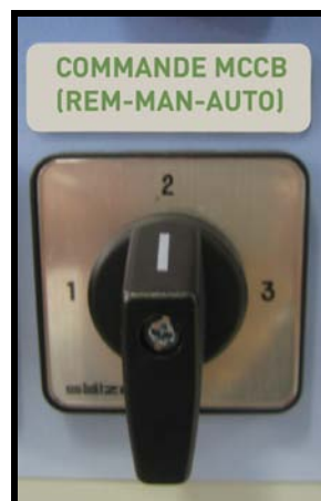
Figure 25. Interrupteur de sélection de commande MCCB (-S6)
