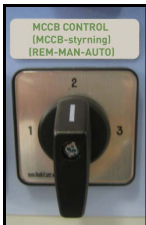
Figur 25. Manöverbrytaren för MCCB-styrning (-S6)
